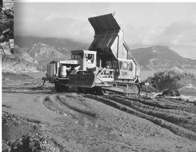
21.1 Travaux de création du port de plaisance de Saint-Jean-Cap-Ferrat, photographies direction départementale de l'équipement, 1963-1975. Arch. dép. Alpes-Maritimes, 824 W 176.
