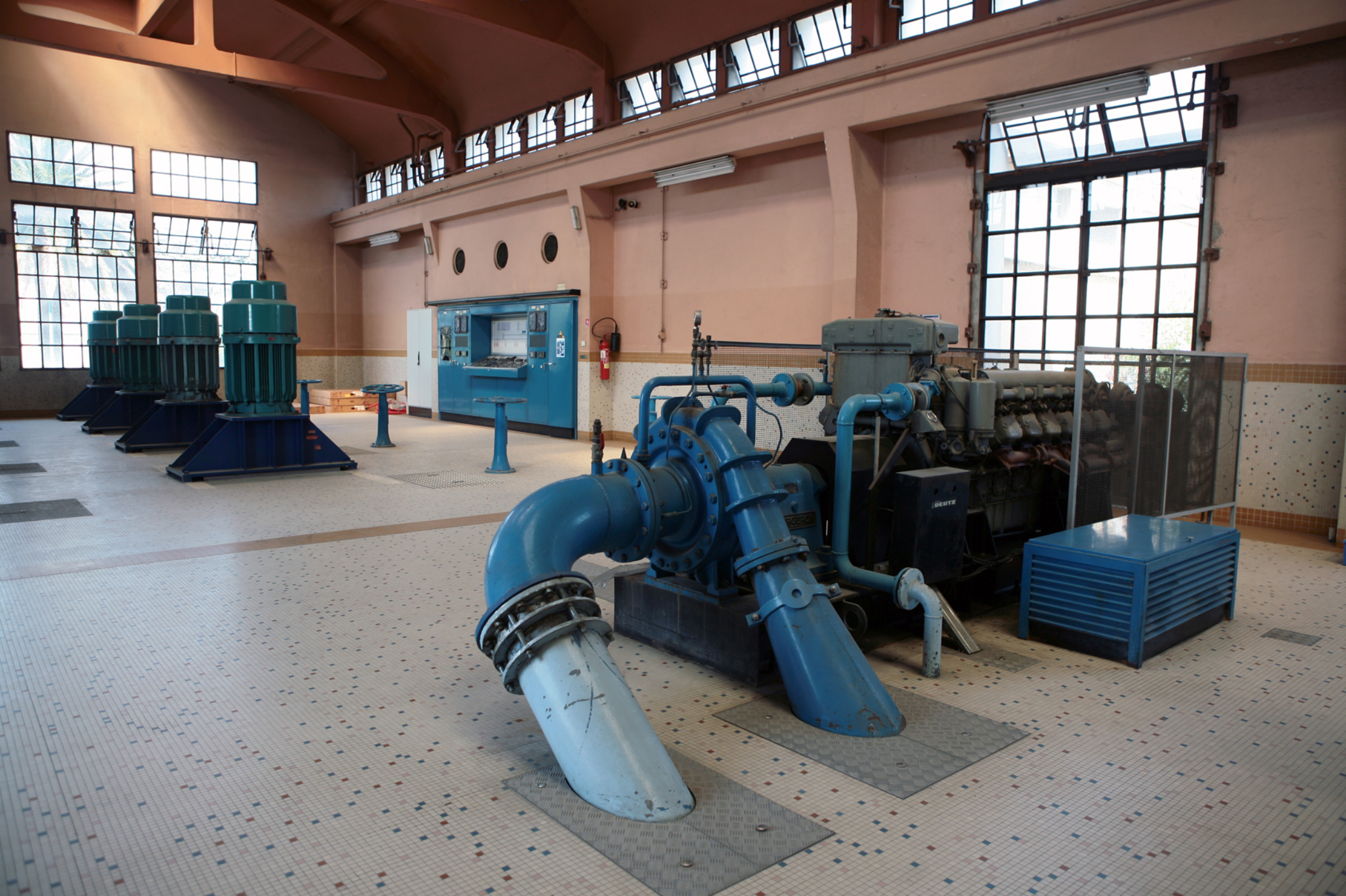
6.6 Installation de pompage de l'usine des Sagnes. AD06, photographie Jean-François Boué
