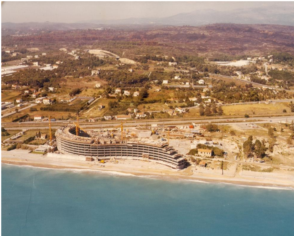
Fig. 9. Le chantier de l'Amiral (1968-1969). Photo de A. M. Baconnet, Cannes. Collection Groupe MARINA. Arch. mun. Villeneuve-Loubet, 16 Num 002.
